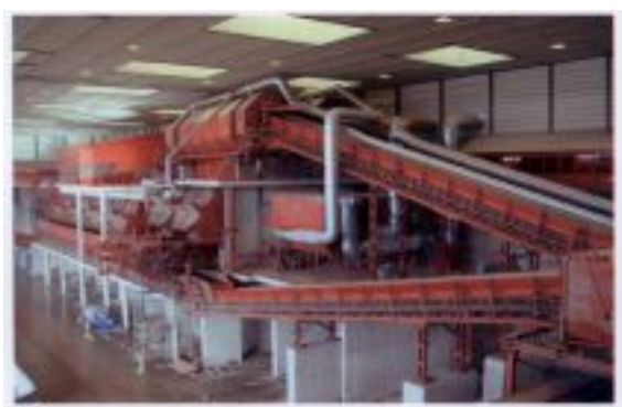
Postrojenje za sortiranje komunalnog otpada Zoom
